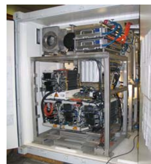
Brennstoffzellencontainer Foto: HFCS
